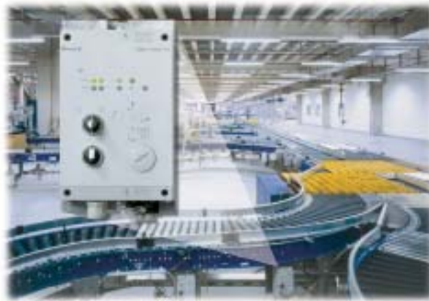
Bild 1: Rapid Link Motor Control Units von Moeller steuern die Packetfördertechnik im Warenverteilzentrum des Otto-Ver-sands dezentral.
