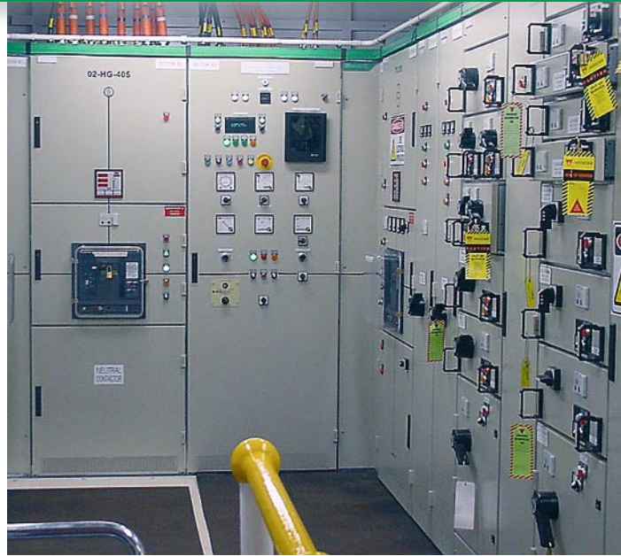
Eine neue Schaltanlage MODAN W mit Netzwerkanschluss zur Leittechnik
