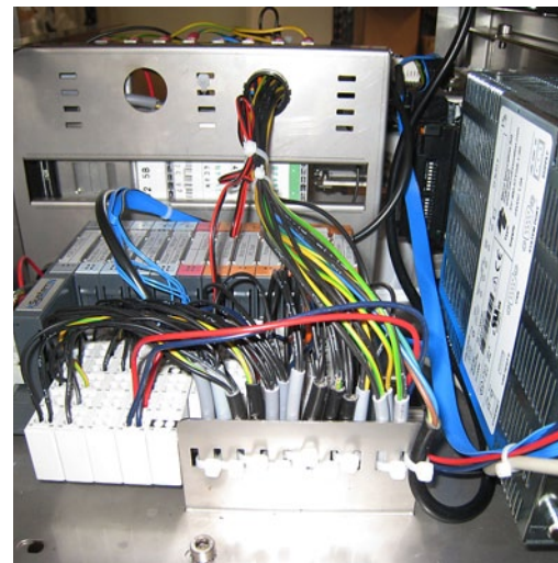
Datensammler: Das remote I/O-System XI/ON ist die Schnittstelle zu den Sensoren und Aktoren.
