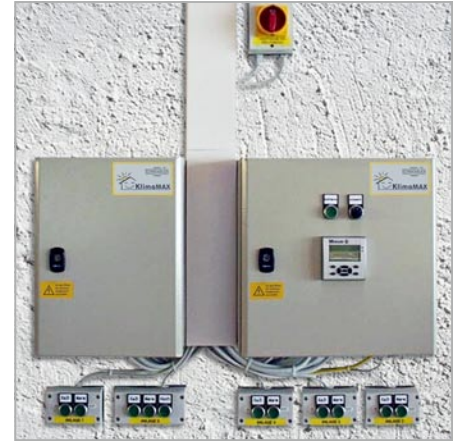
Je nach Bedarf kann vor Ort die Klimasteuerung von Automatik- auf Handbetrieb umgestellt werden.
