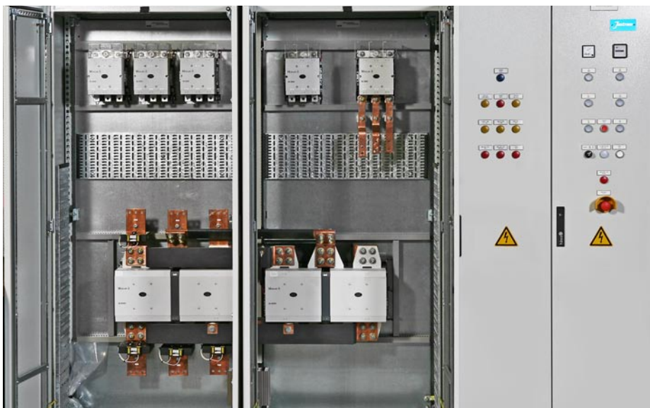
Schaltanlage für eine 700 kW Bugstrahlruderanlage, bestehend aus zwei Leistungsschützen DILM 1600 für die Steuerung der Propellerdrehrichtung sowie DILM 400/ 300 für die Drehzahlsteuerung durch Überbrückung der Widerstände im Läuferkreis.
